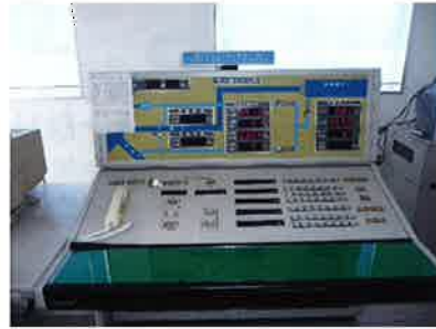
水管理制御システム更新
