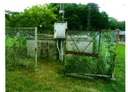
小畑揚水機場
