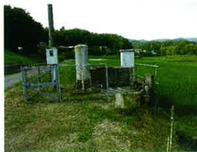
常城揚水機場
