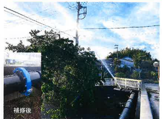
更和線用水路更和水管橋継手部漏水 (R2年4月21日発生)
