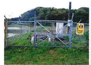
駒場揚水機場 (桜井地先)
