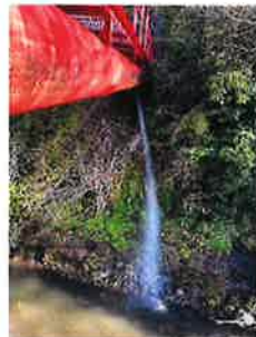
北幹線水路第2号水管橋 大川崎地先 (R4年3月15日発生)
