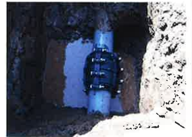
北幹線支線水路関尻地先漏水 VPφ200mm (R4年3月15日発生)
