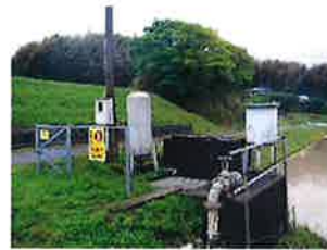
常城揚水機場 (上後地先)
