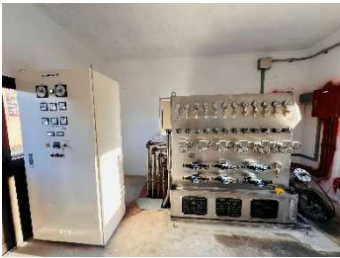
斜樋ゲート機側操作盤・油圧ユニット (戸面原ダム斜樋)
