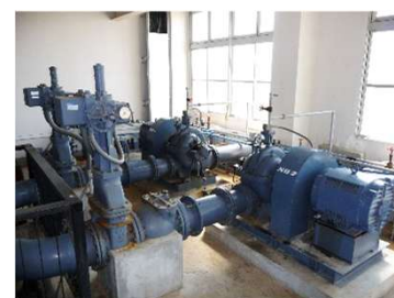
はなわ揚水機場
