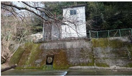
隧道流入工 建屋 (表面被覆)
