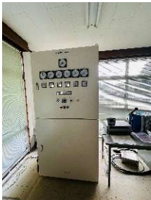
斜樋ゲート遠方操作盤 (戸面原ダム管理棟)
